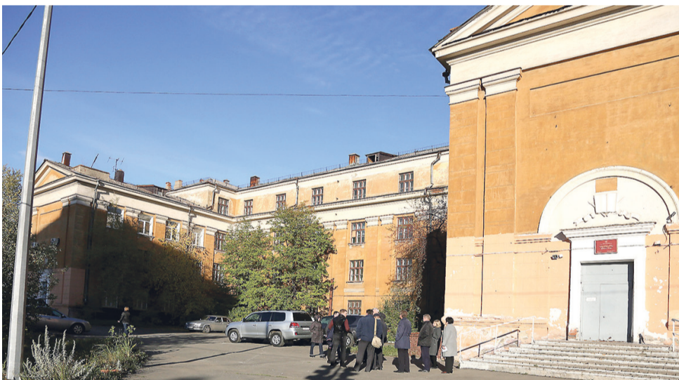
Школа ждет ремонта.
