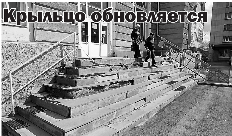
Так выглядело опасное крыльцо до реконструкции.
