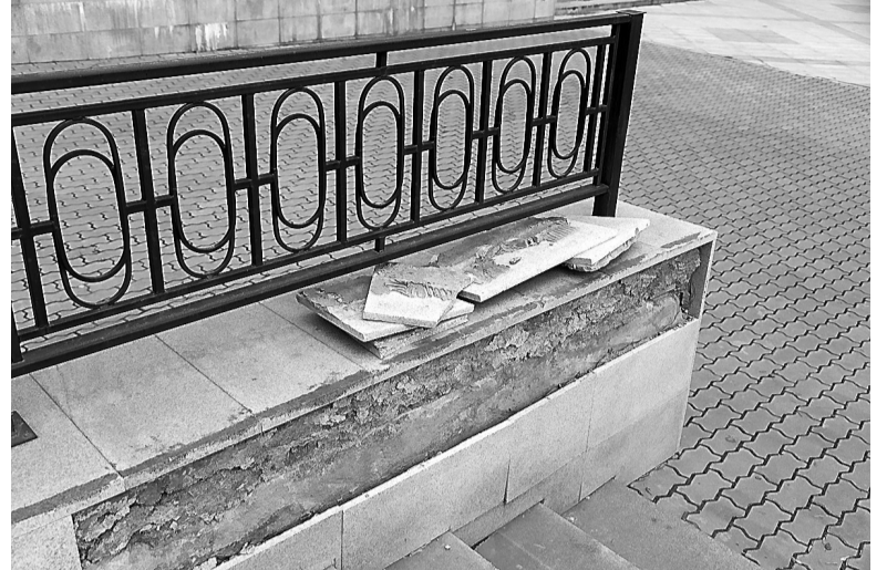
С подпорной стены отпала облицовочная плитка.
