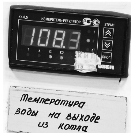
Датчики в котельной ГГМ.
