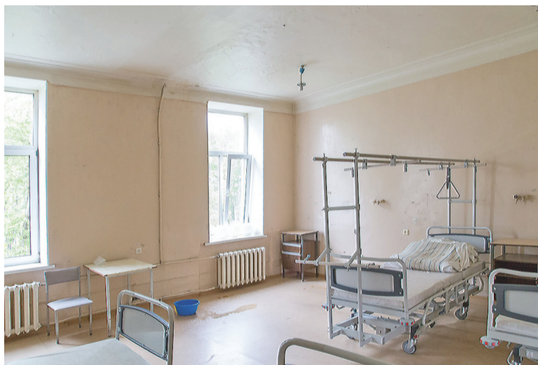
Во время урагана на здании хирургического корпуса повредило крышу, часть палат залило водой.
