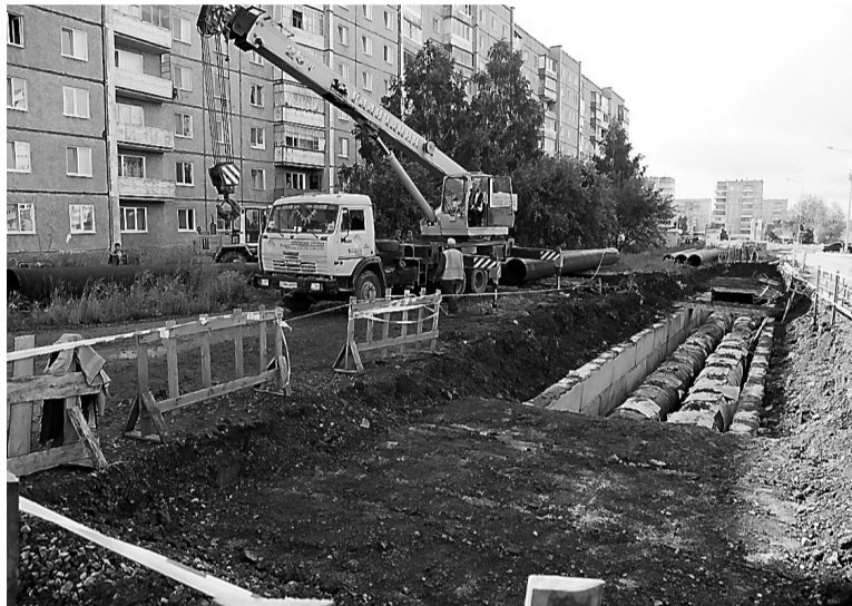
Во вторник начался ремонт трассы восьмисотого диаметра в районе дома № 22 на Октябрьском проспекте. Трубы на участке 100 метров МУП «НТТС» меняет собственными силами, раскоп огорожен знаками. В связи с работами на четыре дня отключена горячая вода в четырех девятиэтажках. К выходным ремонт должны завершить. ФОТО НИКОЛАЯ АНТОНОВА.
