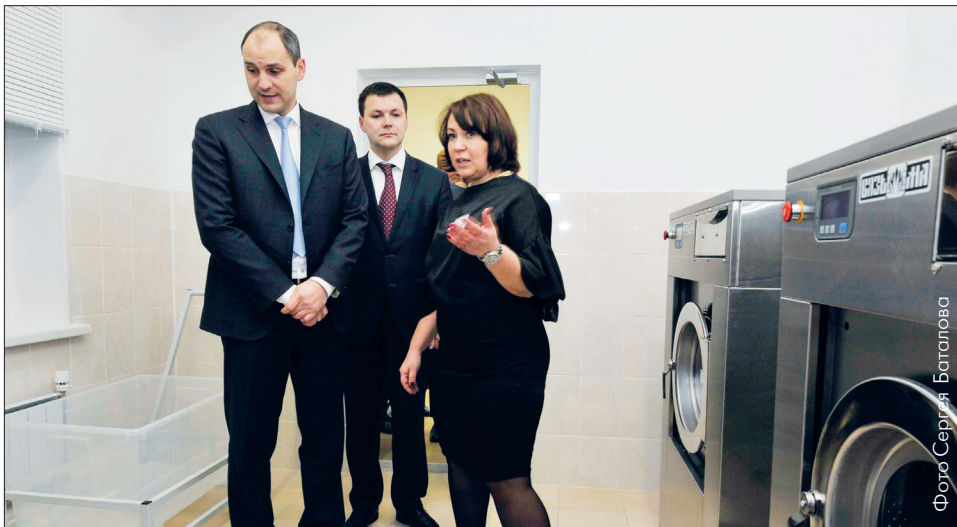
В технических помещениях установлено современное оборудование
