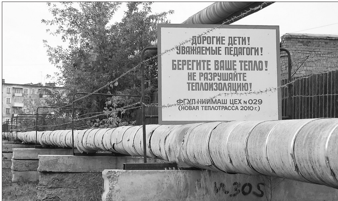
Теплотрассу между школой и гимназией охраняют колючей проволокой.
