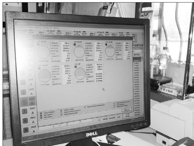
Оператор проверяет количество топлива и отсутствие воды в ёмкостях. Данные об этом высвечиваются на экране монитора компьютера.
