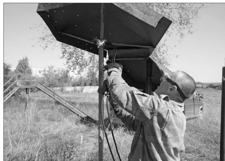
«Чистый город» продолжает демонтаж старых металлоконструкций с дворовых игровых площадок. Очередь уже дошла до площадки у дома №19 по ул. Ломоносова.
