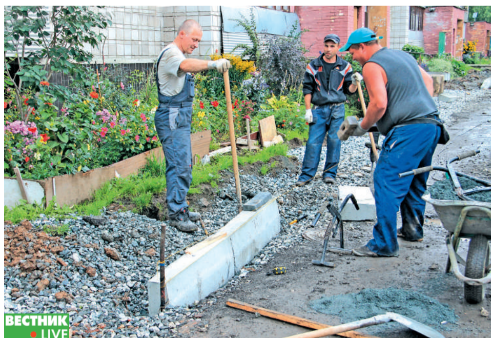
Во дворе домов №№ 14 и 20 по улице Строителей производится установка бордюров по границам тротуаров.
