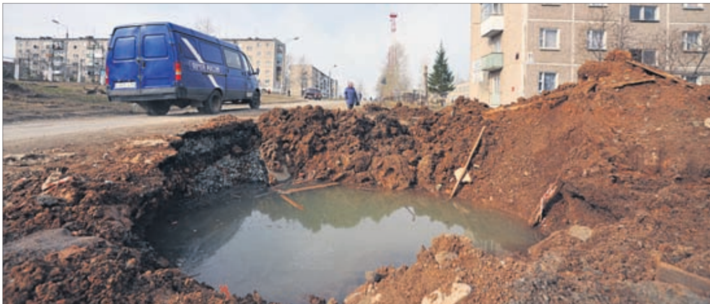
На этом участке водопровода в Новоуткинске аварии ликвидировали уже больше десяти раз. В последний раз работы пришлось начать еще зимой, течь не прекращается, уже подмывает дорогу. Воду откачивают несколько раз в сутки, чтобы она не поступала в подвалы близлежащих домов. В «Домоуправлении» говорят, что трубу будут менять, как только оттаяет земля, на это деньги они найдут.
