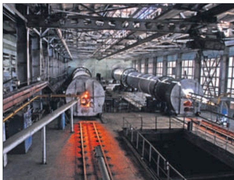
Прокаточные печи производства монохромата натрия
