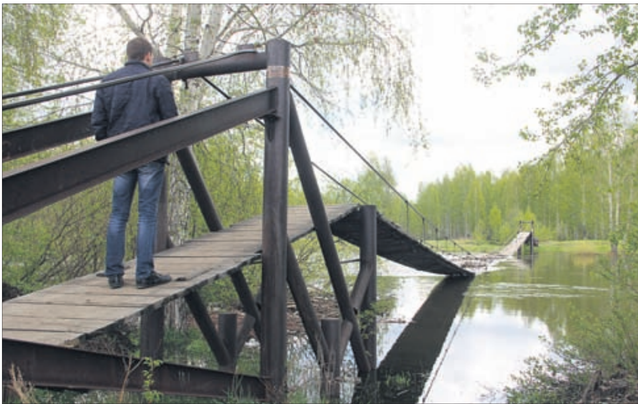
Висячий мост в районе улицы Чернышевского затоплен.
