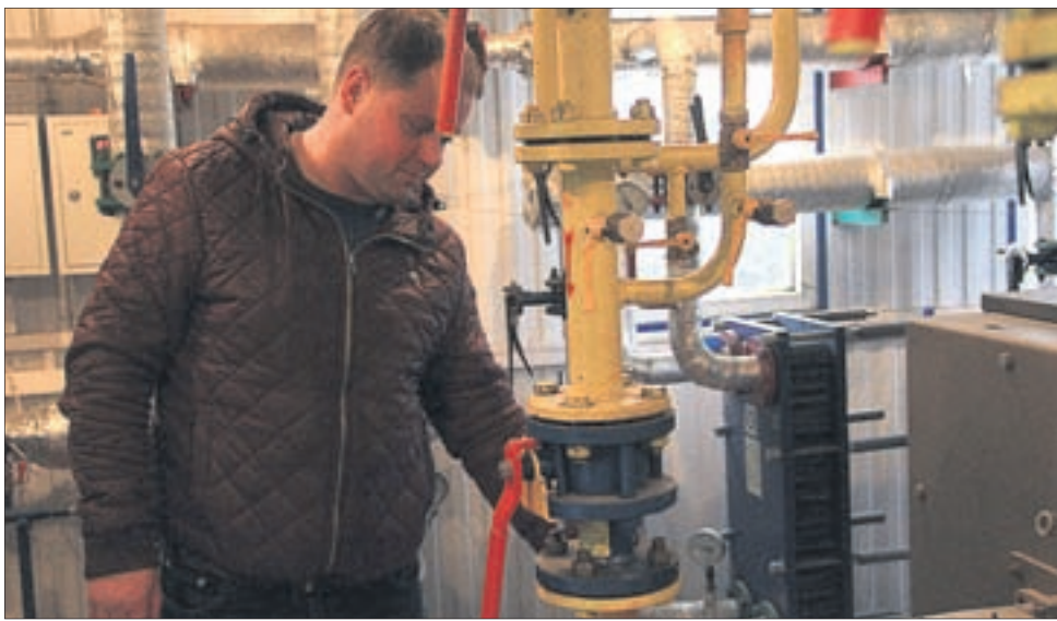
Сейчас, по словам Юрия Прохорова, убыточных котельных в Первоуральске нет. Для этого пришлось полностью модернизировать имеющиеся и от топки углем перейти на газ. Новые модульные здания, новое оборудование, большие мощности. Также отказались от труда человека, полностью автоматизировав процесс: больше нет пары рабочих, кидающих уголь в топку, а есть диспетчерский пульт. Например, котельная в Новоалексеевском отопляет школу, детский сад и частный сектор (который топить не выгодно). Котельная в Шайтанке полностью обеспечивает теплом частный сектор.
