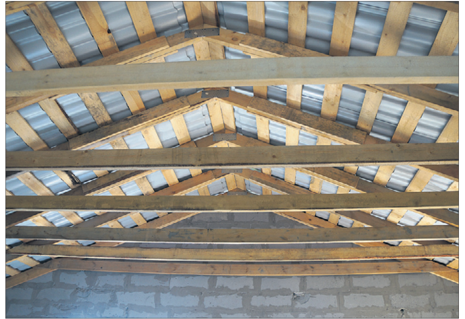
Крыша нуждается в обновлении примерно через 30 лет.
