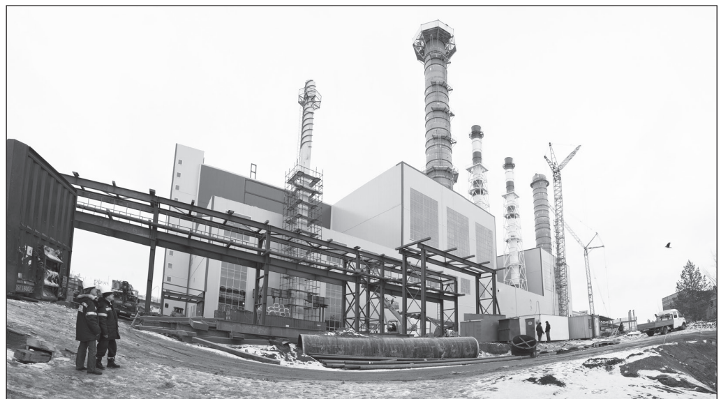
В конце 2015 года новая теплостанция должна начать работу.
