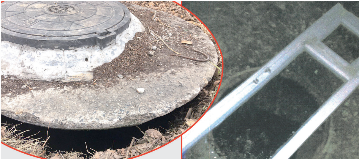
Крышка колодца по Советской, 25 на месте. Проблема в бетонной плите, которая находится не на месте. А на Машиностроителей, 8 колодцам с открытыми люками уже две недели.
