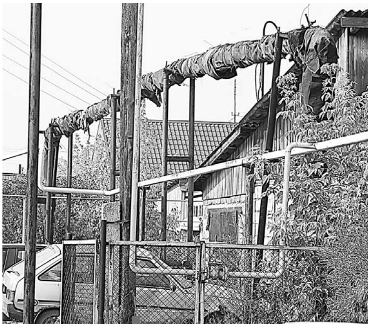
Теплотрасса и газопровод на ул. Степной в селе Курьи
