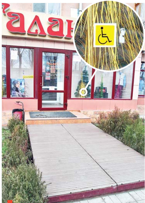
Кнопка вырвана, пандус отсутствует
