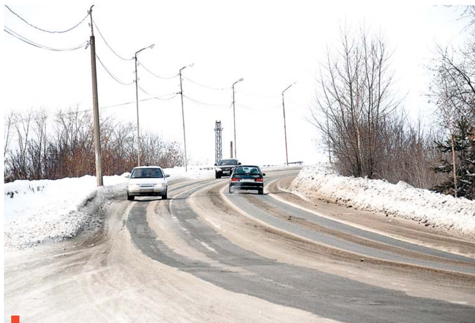
Путепровод над железнодорожными путями требует ремонта
