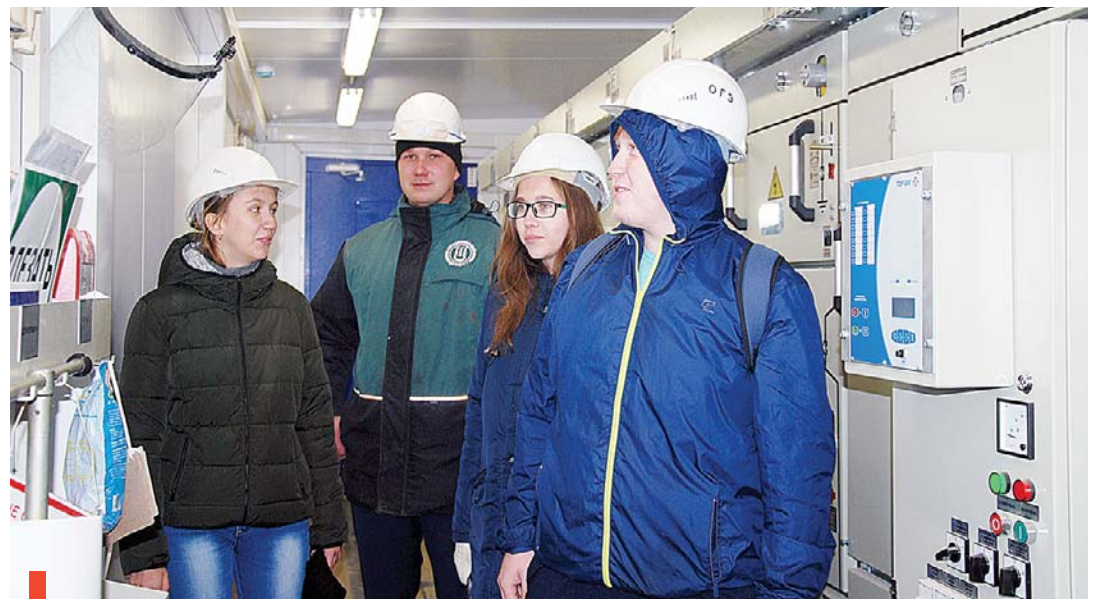
Современное оборудование на новой электроподстанции шестой помольной мельницы
