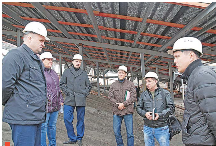
Ремонт крыши ДК «Кристалл» под личным контролем главы городского округа Романа Валова
