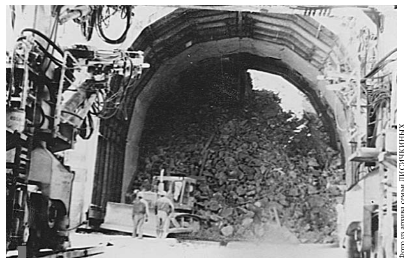
Обвал породы в тоннеле
