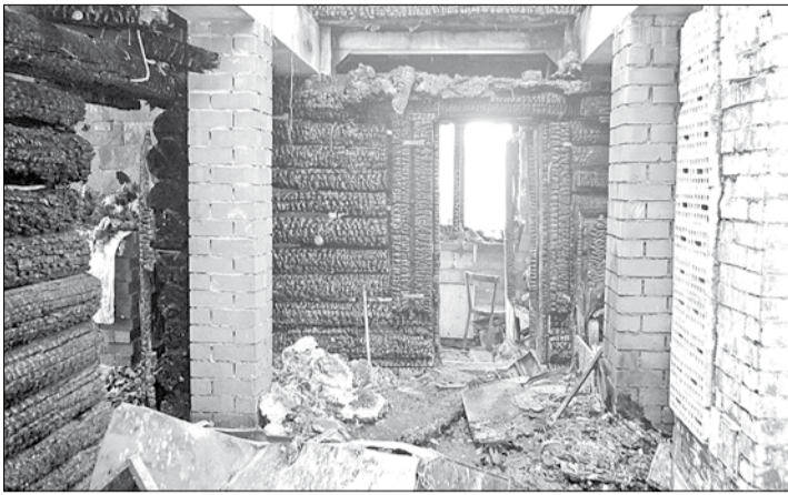
Каменные и кирпичные конструкции дома остались целы, а вот деревянные перекрытия выгорели дотла. Фото предоставлено Госпожнадзором города Берёзовского
