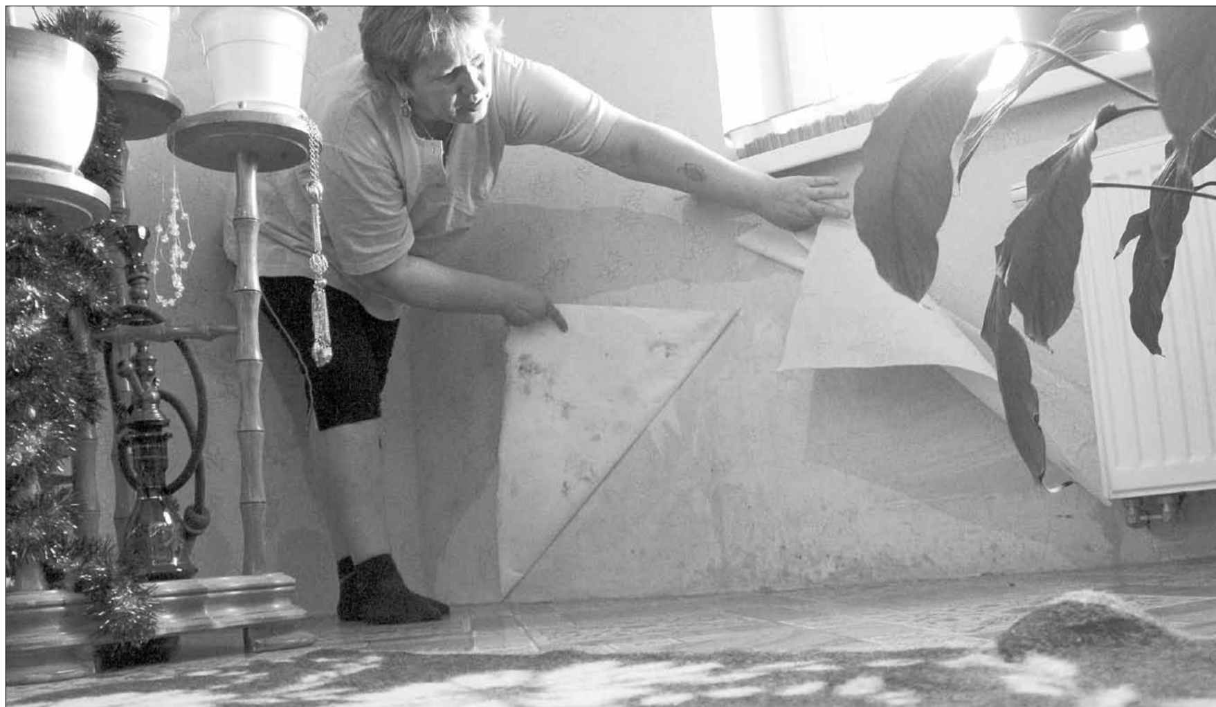
Любовь Дулова показывает последствия гидроизоляции. По словам березовчанки, она не раз переклеивала обои в квартире и до сих пор не может полноценно прожить в купленном год назад жилье. Фото Павла Шабельникова
