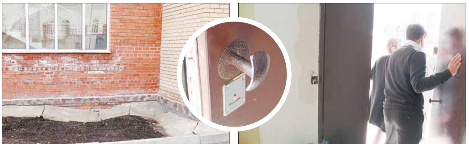
«Просевшую» отмостку здания старопышминского садика подрядчик готовится ремонтировать за свой счёт. Фото Павла Шабельникова
