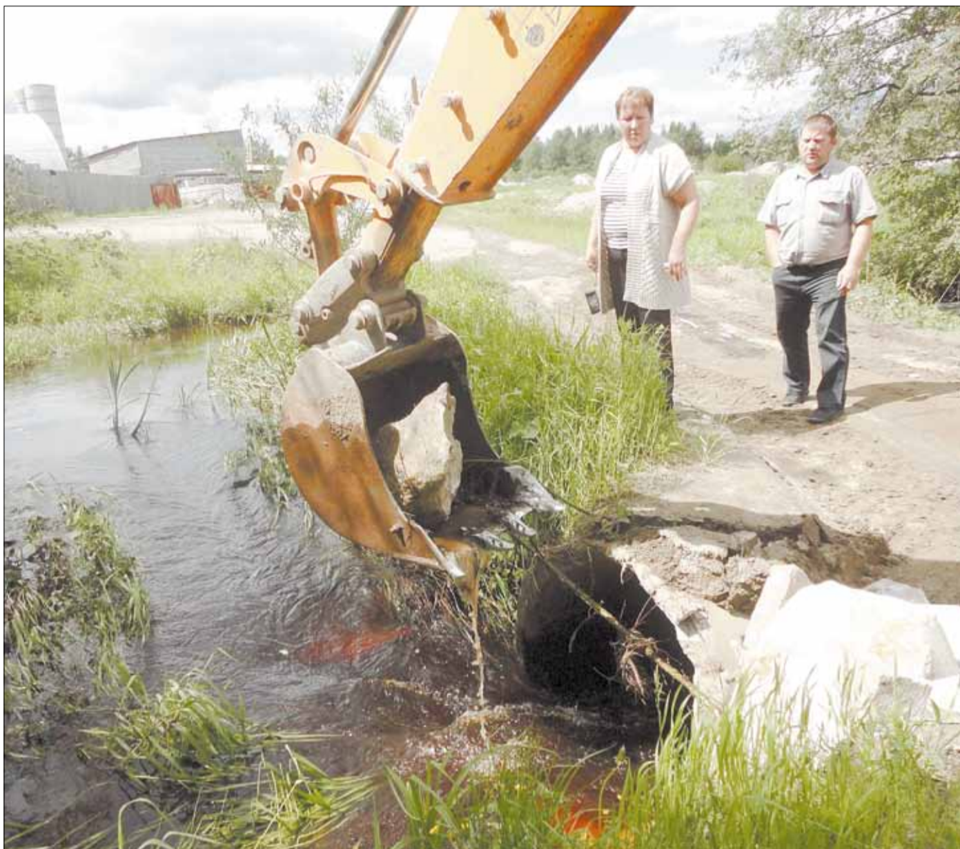
Камень, мешавший проходу воды в одной из труб грунтового переезда, по просьбе главы поселка Галины Упоровой был убран с помощью прибывшего для починки моста экскаватора. Фото Олега Манварова
