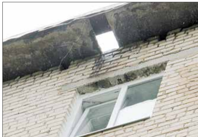
В кровле над квартирой Тамары Петровой зияет огромная дыра. Фото Олега Манварова
