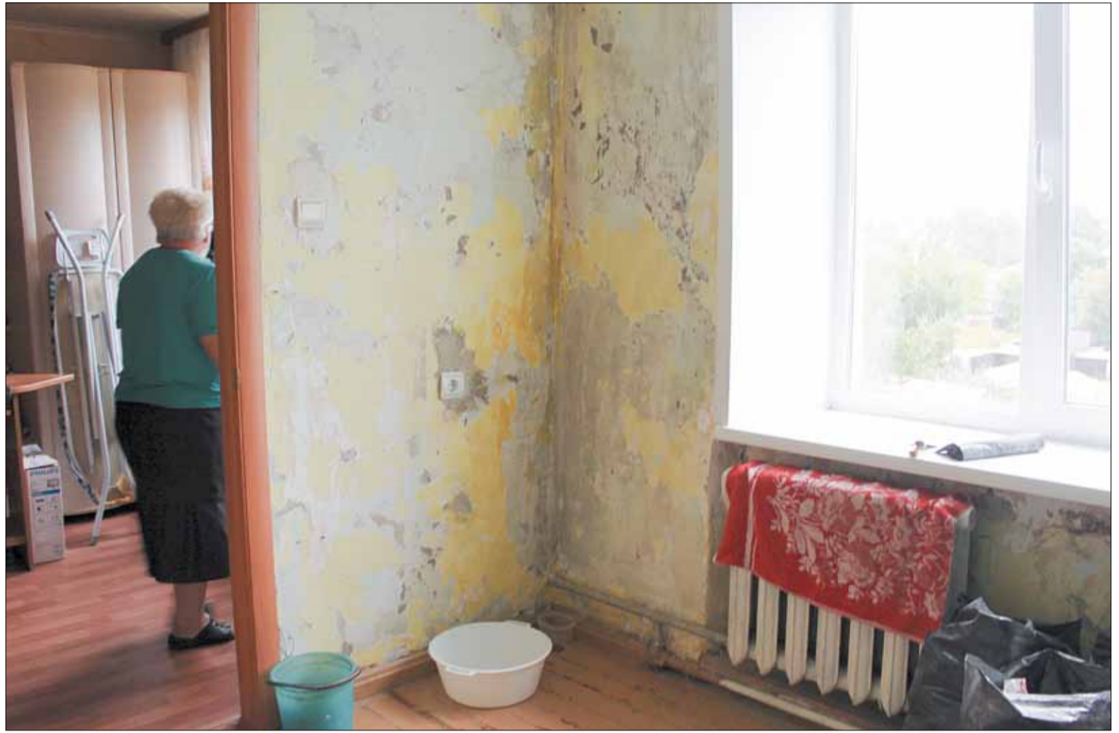
Крайняя комната в квартире Тамары Петровой страдает больше остальных помещений. Потолок покрыт плесенью, а сквозь щели сочится вода. Фото Валентины Завойской
