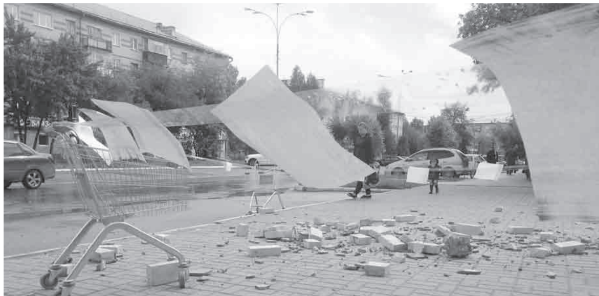
Сразу после обрушения работники магазина огородили ленточками опасное место. Фото Павла Шабельникова
