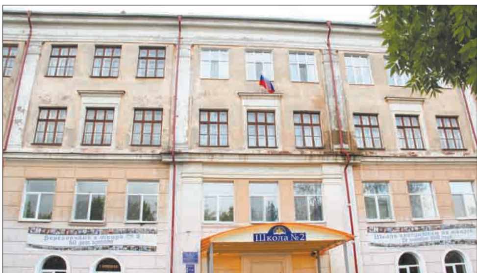
Фасад здания школы № 2 требует ремонта. Фото Павла Шабельникова
