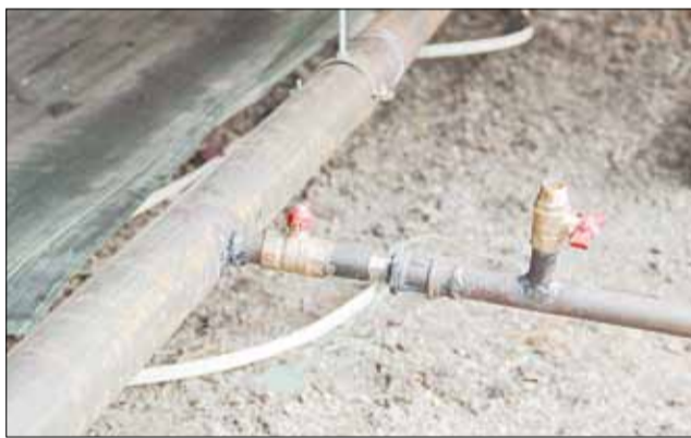
Разводка системы отопления в доме по ул. Шиловская, 5 на крыше смонтирована, новые трубы временно приварены к старым стоякам, но отопления в доме нет
