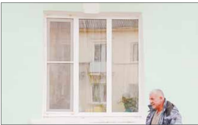
Проверяющим не понравилось, что подрядчик не исправил кривые линии стен и откосов дома № 28 в поселке Первомайском
