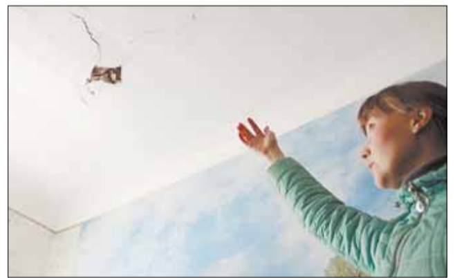
Обрушившийся потолок в квартире Натальи Кудряшовой, жительницы 27-го дома в Первомайском
