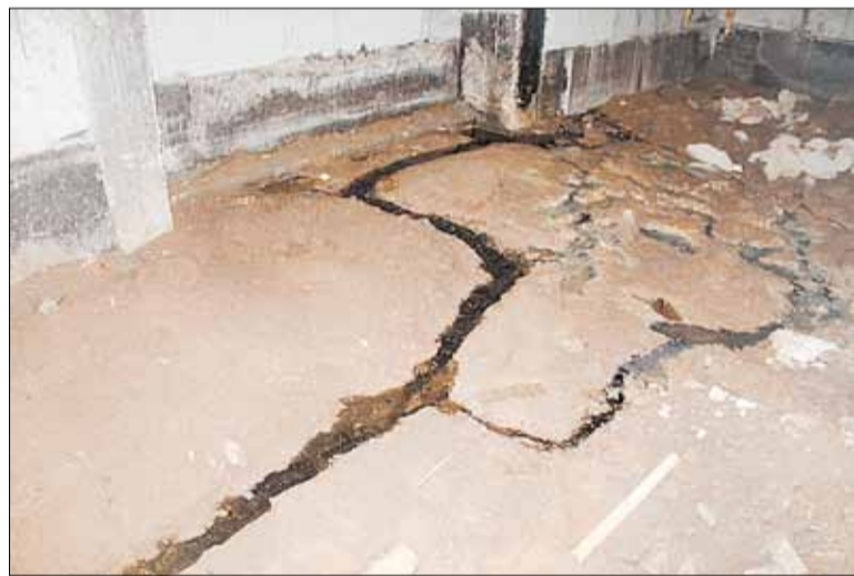
Ручей в подвале одного из домов на ул. Виктора Чечвия. Фото Елены Ивашевской
