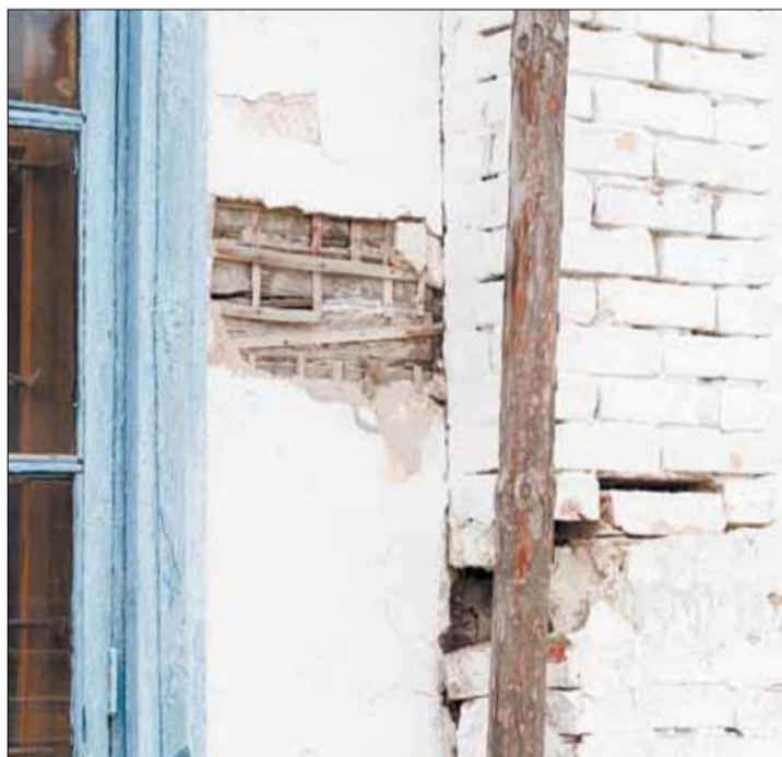
Трещины на фасаде закрытого спортзала. Фото Ксении Тиминой
