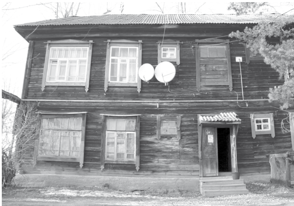
Дом № 32 по ул. Ленина расположен на гостевом маршруте города. Подлежит расселению до 2016 года. Фото Павла Шабельникова
