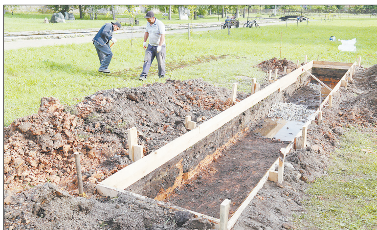
Чтобы посадить будущее «Сейчасстье» в землю, понадобилось вырыть яму и сделать деревянную опалубку
