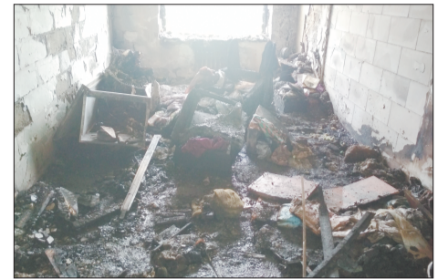
Последствия квартирнго застолья в Шилловском микрорайоне / Фото предоставлено Госпожнадзором
