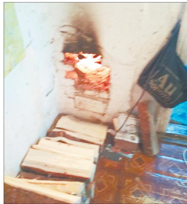
В таком состоянии обнаружили печь в многоквартирном доме представители надзорного ведомства во время рейда. Фото предоставлено Госпожнадзором
