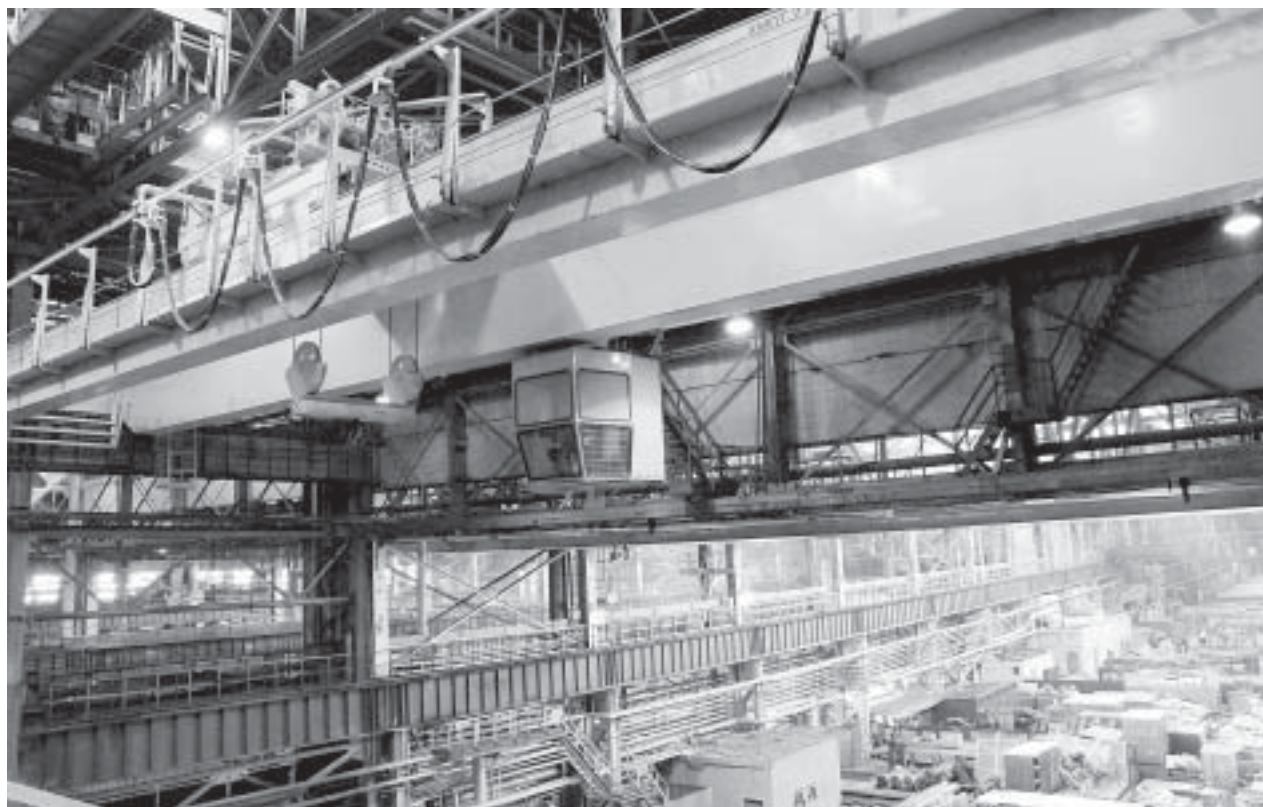
Новый мостовой кран на первом термическом участке ЦХП
